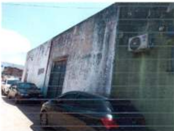
Foto 02- Fachada Lateral necessitando de pintura.
