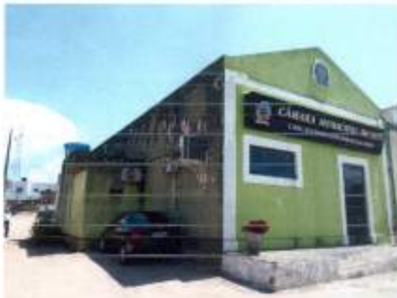
Foto 01 – Fachada principal necessitando de pintura.
