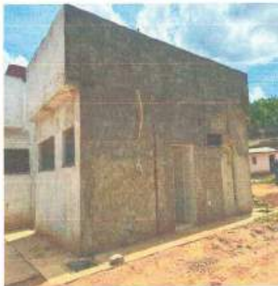
Falta de revestimento de parede externa
