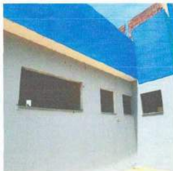
Esquadrias de alumínio não assentadas
