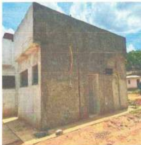
Falta de revestimento de parede externa
