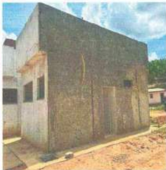
Falta de revestimento de parede externa
