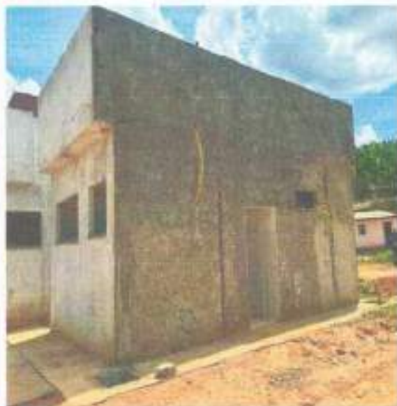
Falha de revestimento de parede externa
