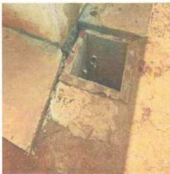
Caixa de Inspeção mal executada e sem tampa
