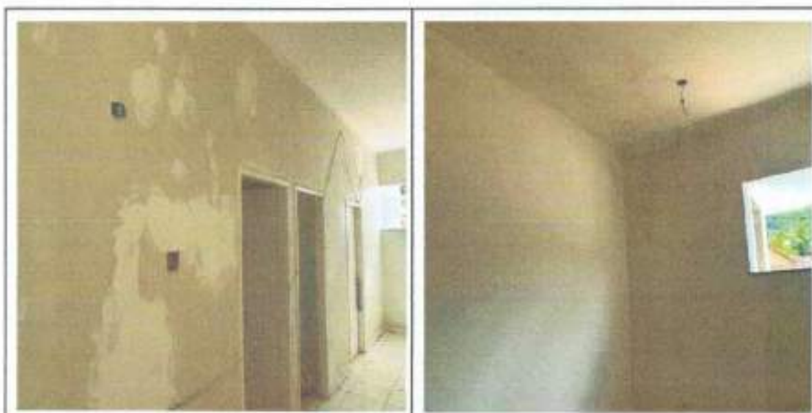
Pintura desgastada e mal executada
