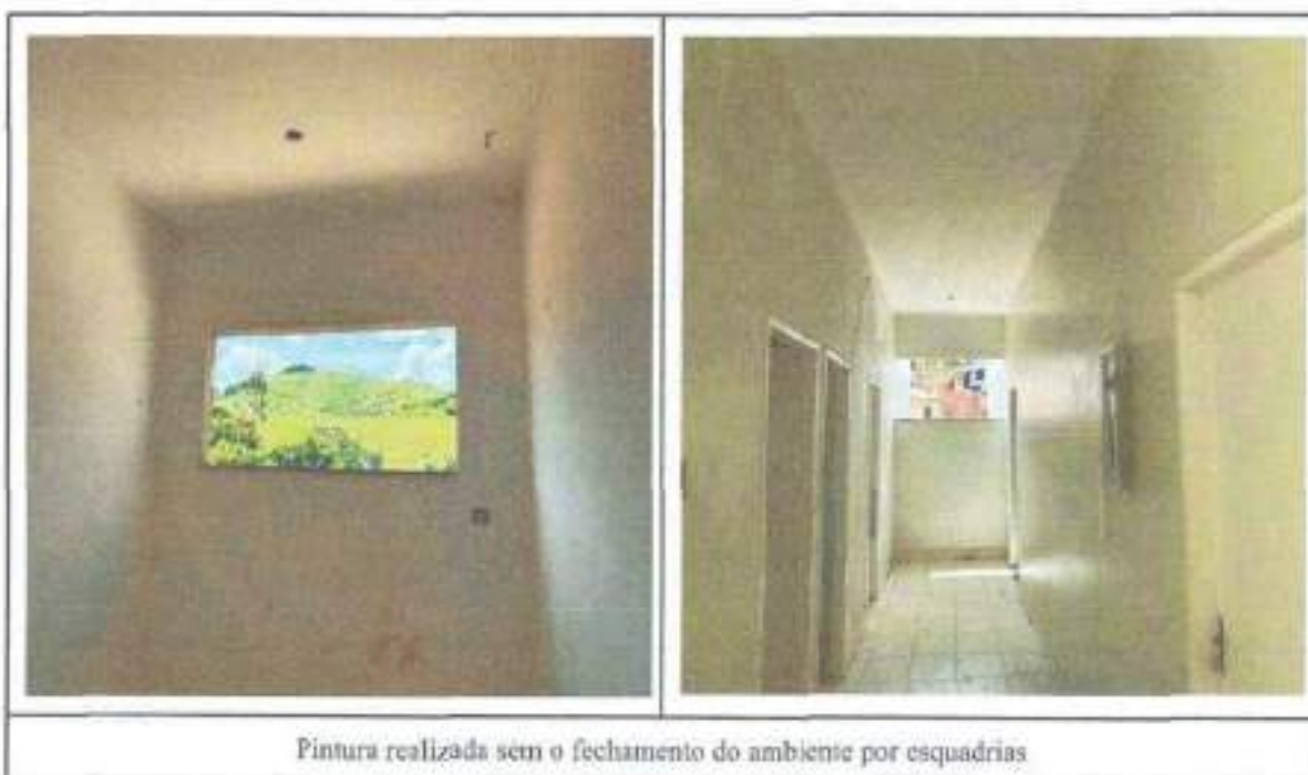
Pintura desgastada e mal executada
