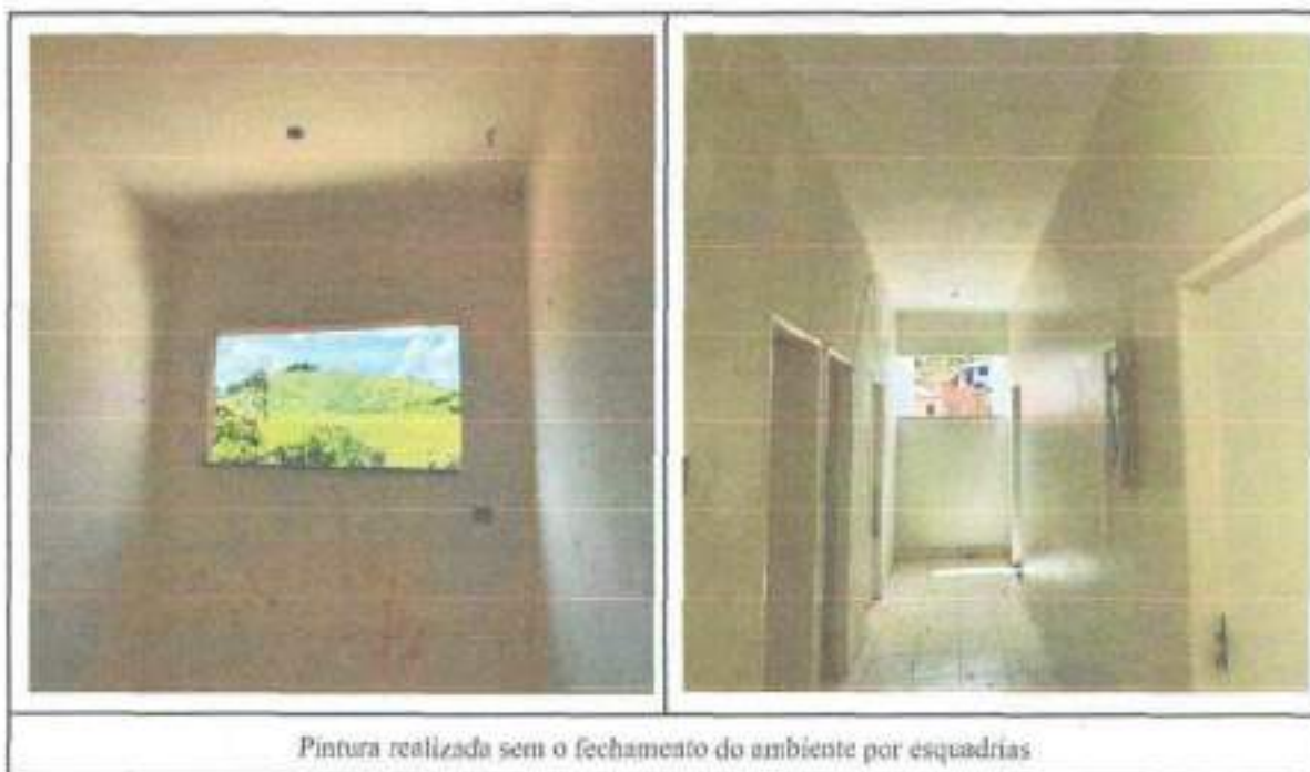
Pintura desgastada e mal executada
