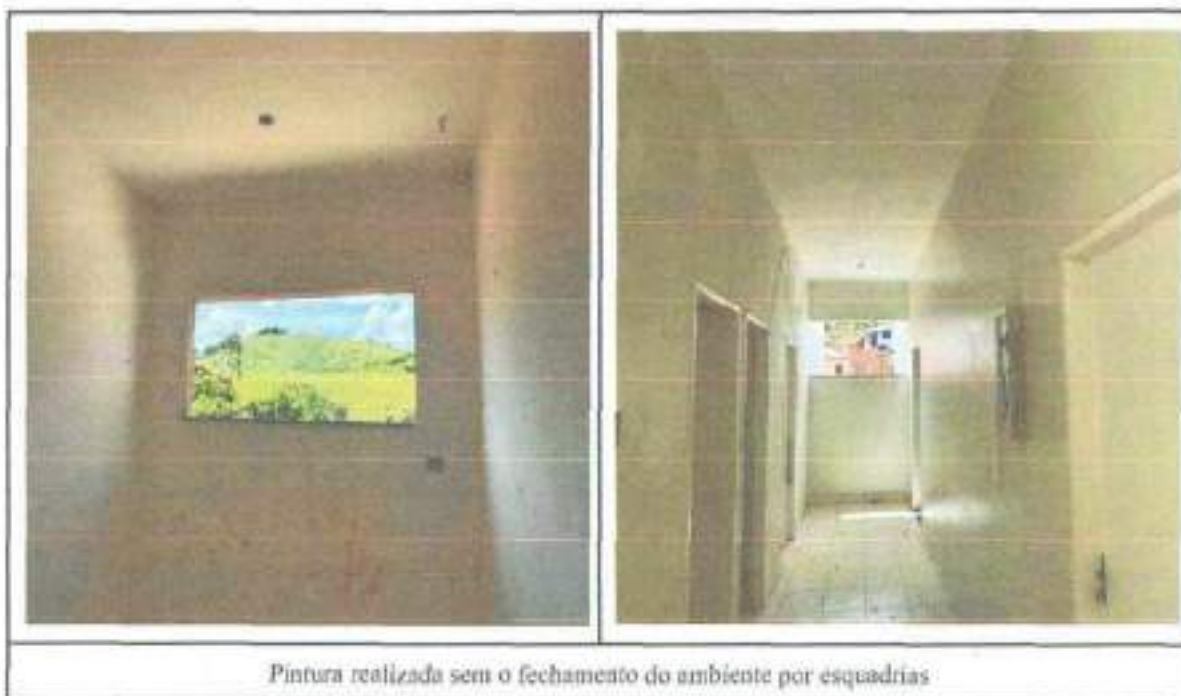
Pintura desgastada e mal executada
