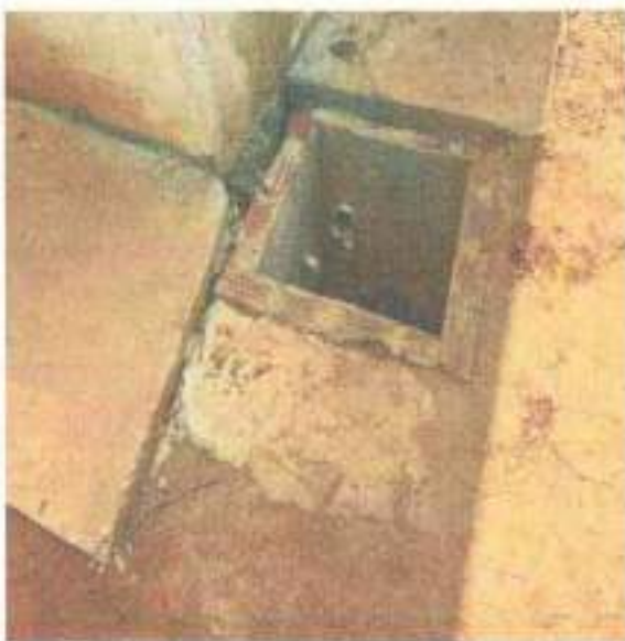
Caixa de Inspeção mal executada e sem tampa
