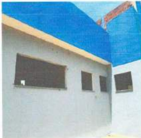
Esquadrias de alumínio não assentadas
