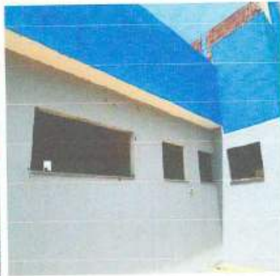
Esquadrias de alumínio não assentadas
