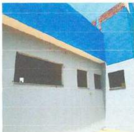
Esquadrias de alumínio não assentadas
