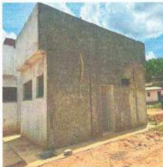
Falta de revestimento de parede externa
