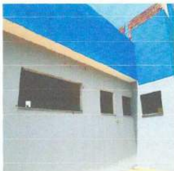
Esquadrias de alumínio não assentadas
