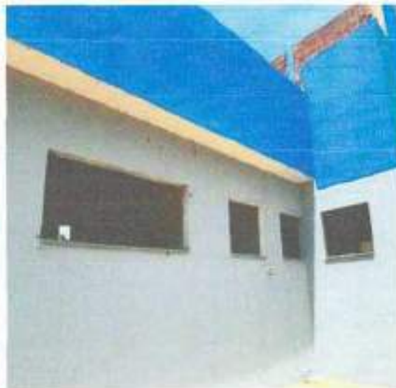
Esquadrias de alumínio não assentadas
