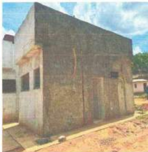
Falta de revestimento de parede externa
