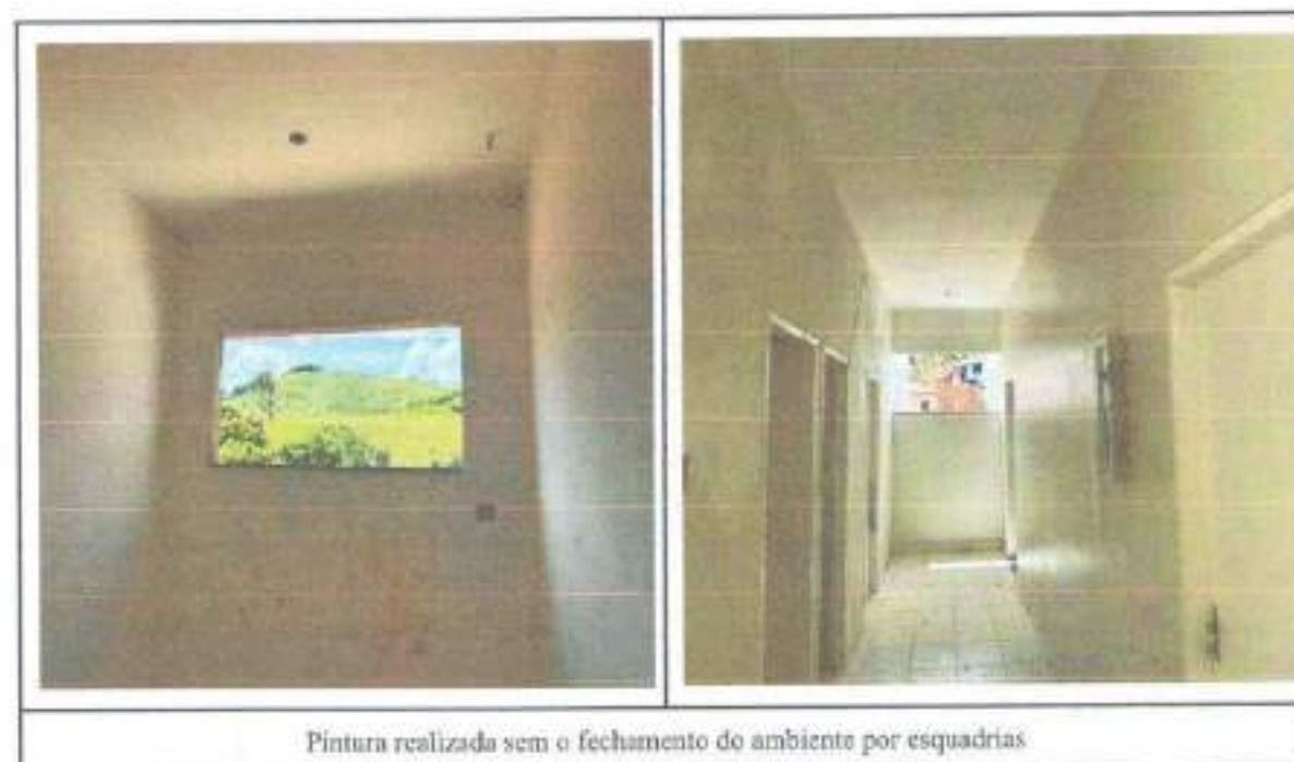
Pintura desgastada e mal executada
