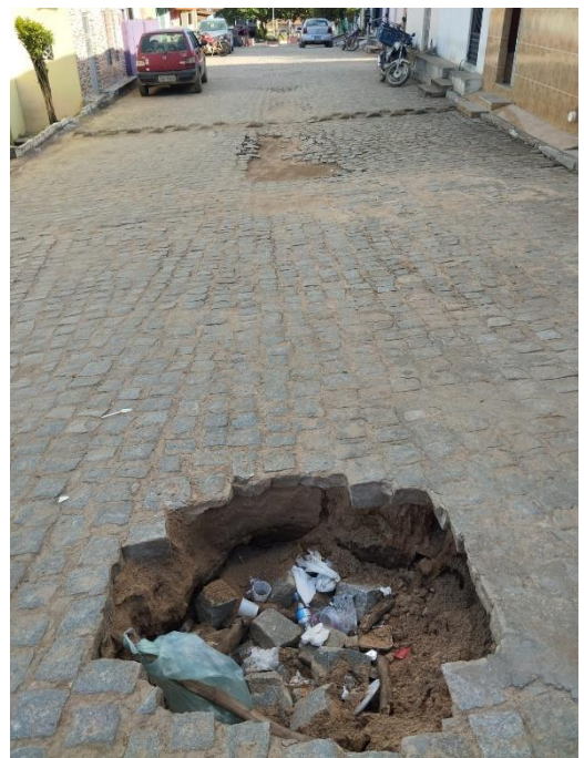
Figura 4 - Recalques no pavimento devido a estouramentos na rede coletora existente.
