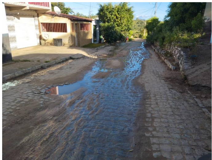
Figura 2 - Vazamento sobre o pavimento existente.
