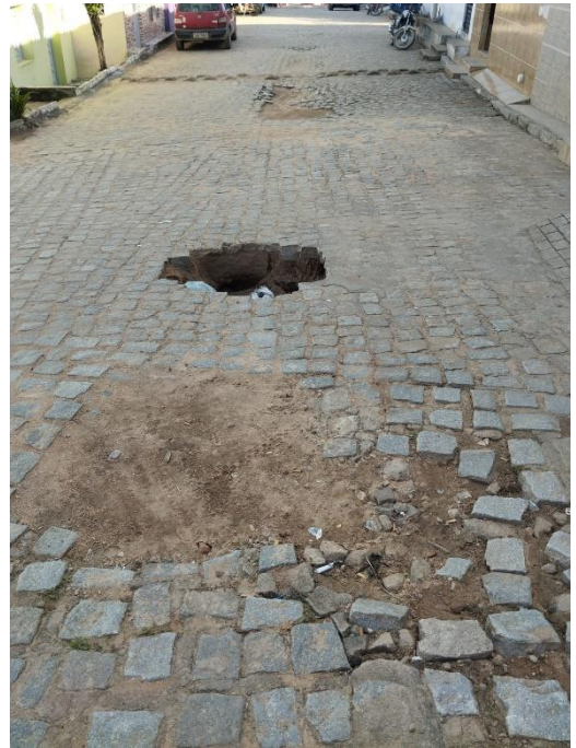
Figura 3 - Recalques no pavimento devido a esturamentos na rede coletora existente.
