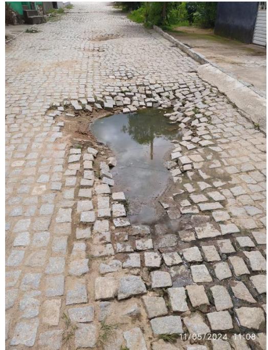
Figura 1 - Recalque do pavimento causado pelo estouramento da rede coletora existente.
