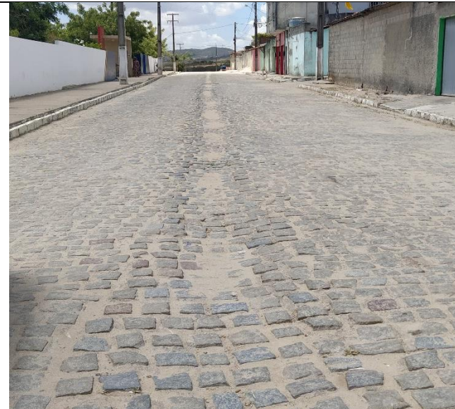
Foto 15 – Afundamento no centro da rua – Rua 13
