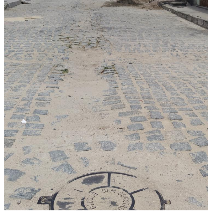
Foto 13 - vala no centro da rua – Rua 02
