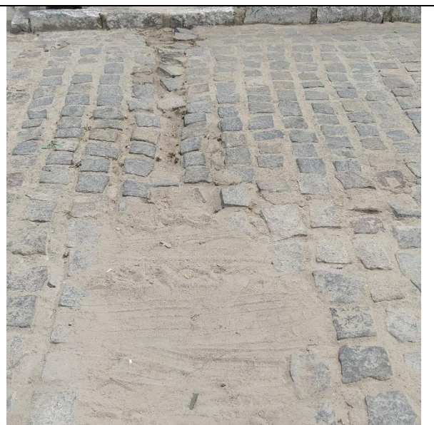
Foto 04- Buracos na rua – Rua 02
