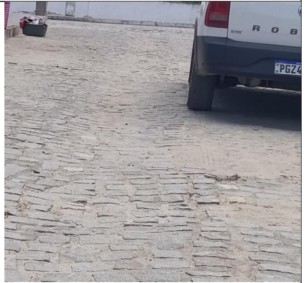
Foto 16 – Afundamento no centro da rua – Rua 4
