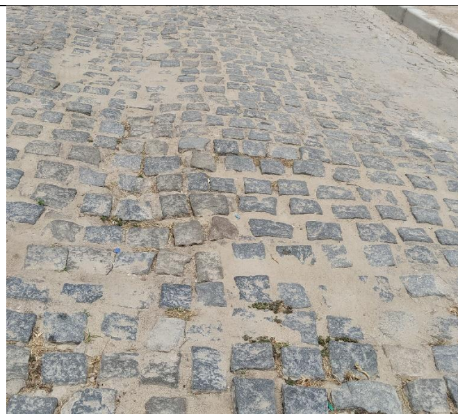
Foto 03- Afundamento no início da rua – Rua 02
