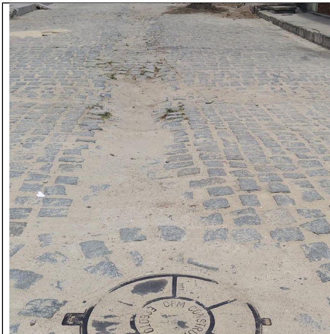
Foto 13 - vala no centro da rua – Rua 02
