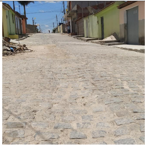
Foto 08- Afundamento no centro da rua – Rua 03
