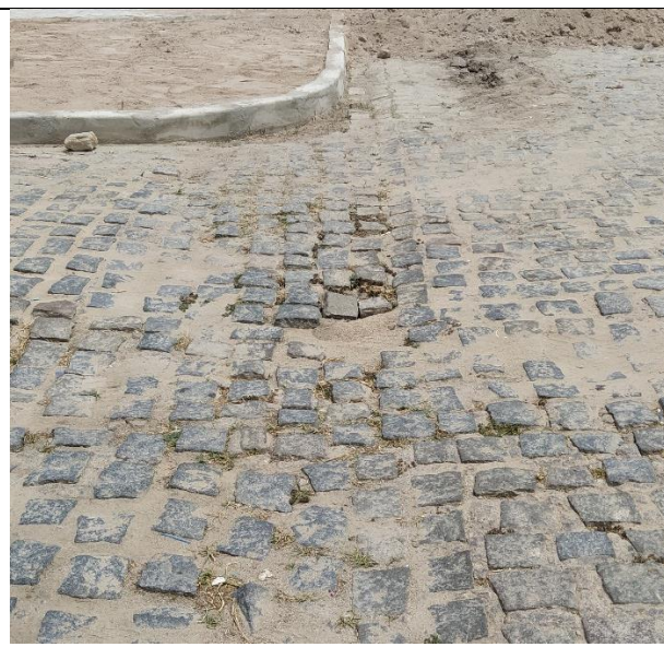
Foto 02- Buracos no início da rua – Rua 01
