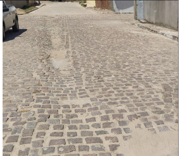
Foto 06- vala no centro da rua – Rua 03
