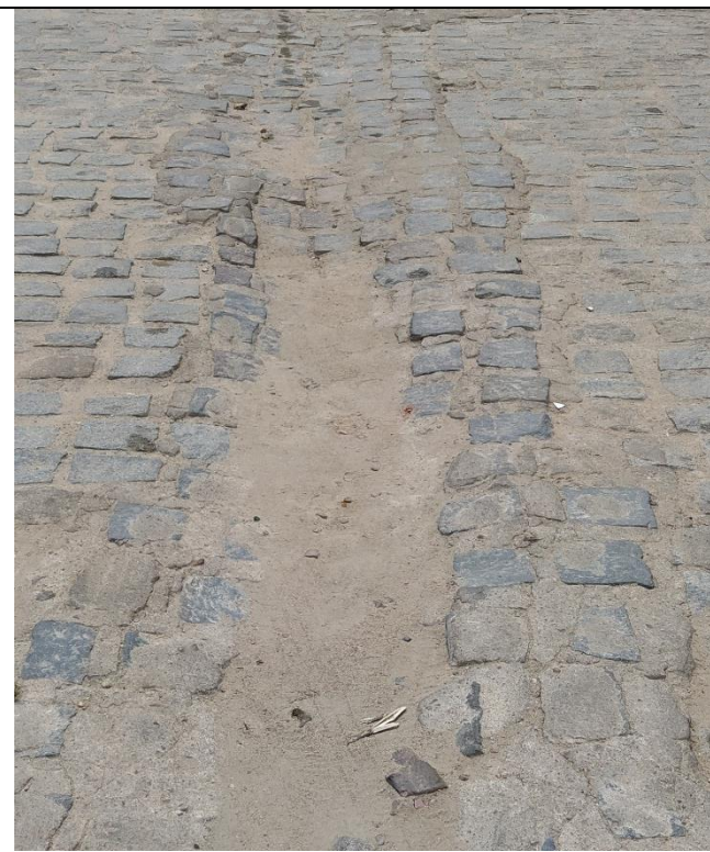
Foto 11 - Vala no centro da rua – Rua 04
