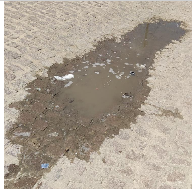
Foto 09- Buraco na rua – Rua 09
