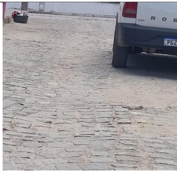
Foto 16 – Afundamento no centro da rua – Rua 4
