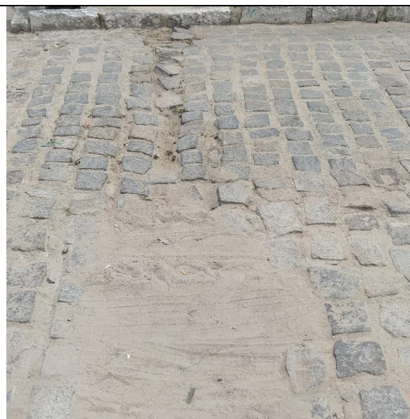
Foto 04- Buracos na rua – Rua 02
