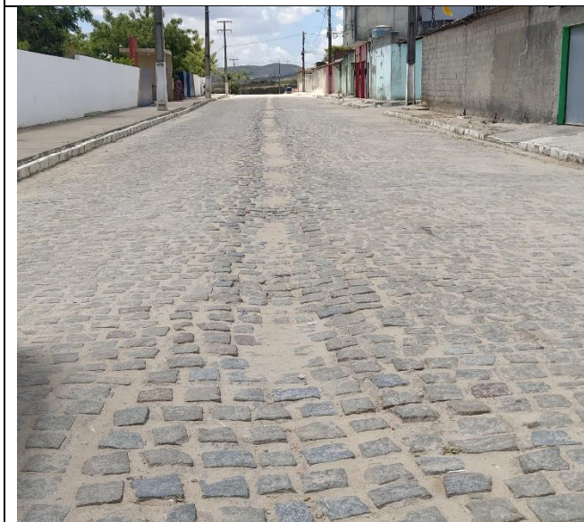
Foto 15 – Afundamento no centro da rua – Rua 13
