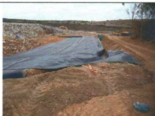
Foto 4 – Utilização de manta de PEAD, para impermeabilização da ampliação da célula de resíduos
